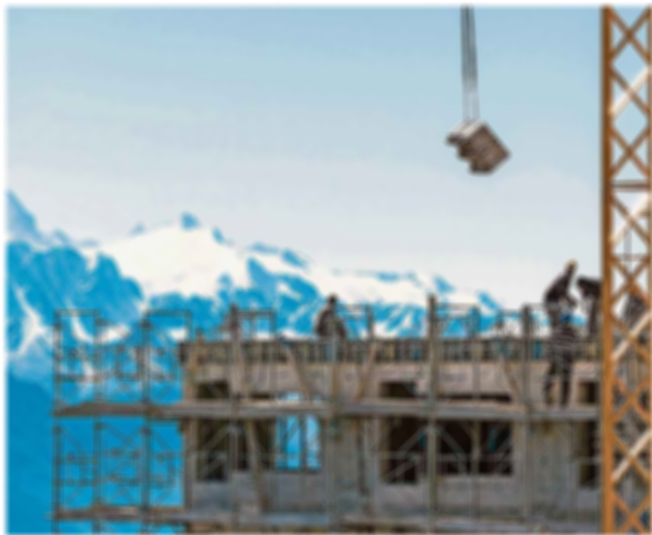
Die Bauherren sind verärgert über die Eingriffe der Kantonalen Verwaltung. Sie fordern eine Klärung der Situation.
